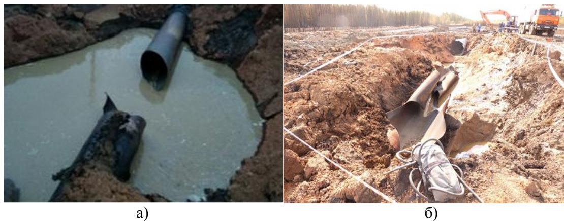
Рис. 1. Последствия аварий на МГ:
